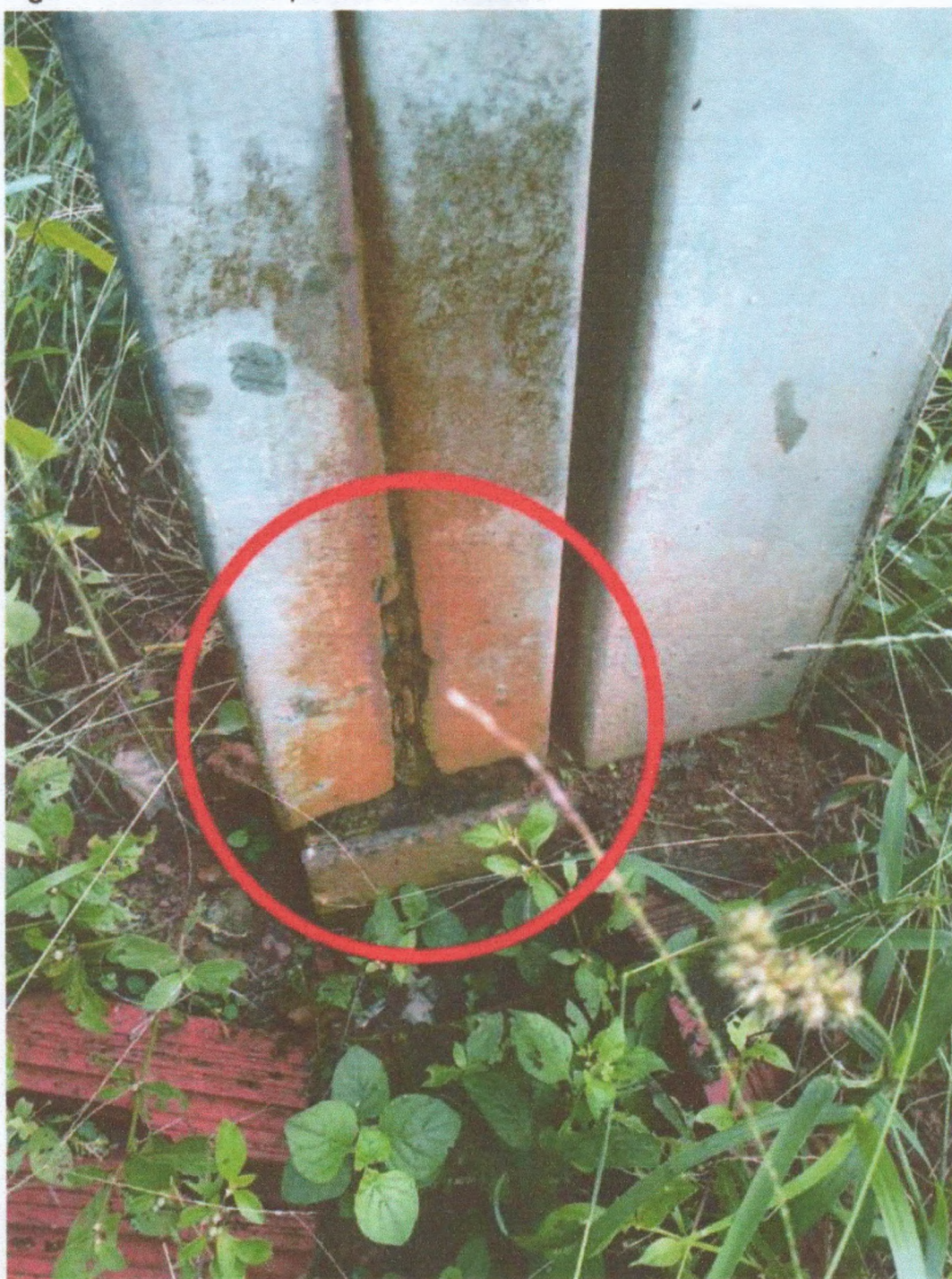
Figura 12. corrosão no pé direito da estrutura
