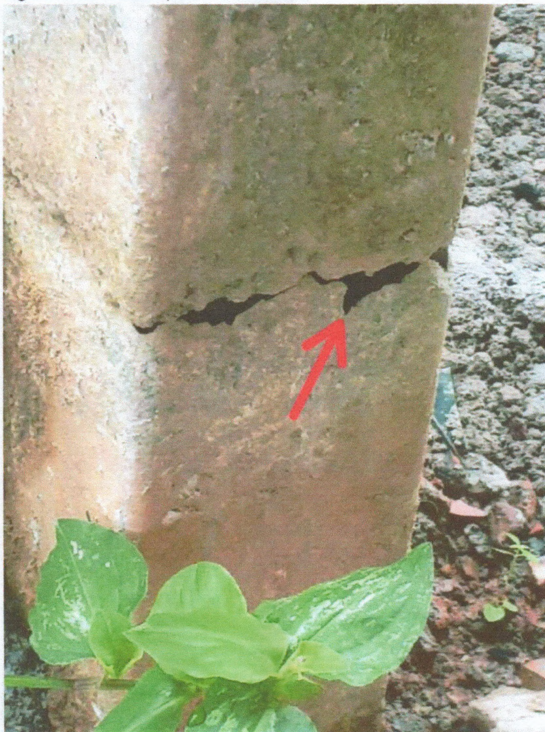
Figura 15. corrosão no pé direito da estrutura
