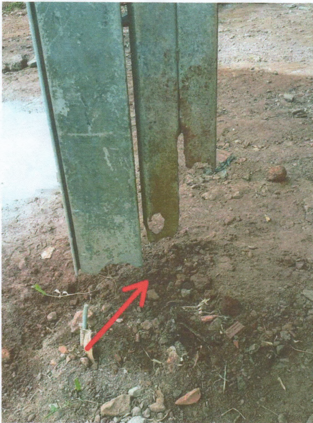
Figura 14. corrosão no pé direito da estrutura ficando totalmente aéreo
