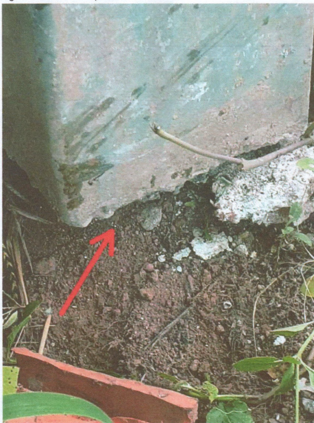
Figura 16. corrosão no pé direito da estrutura
