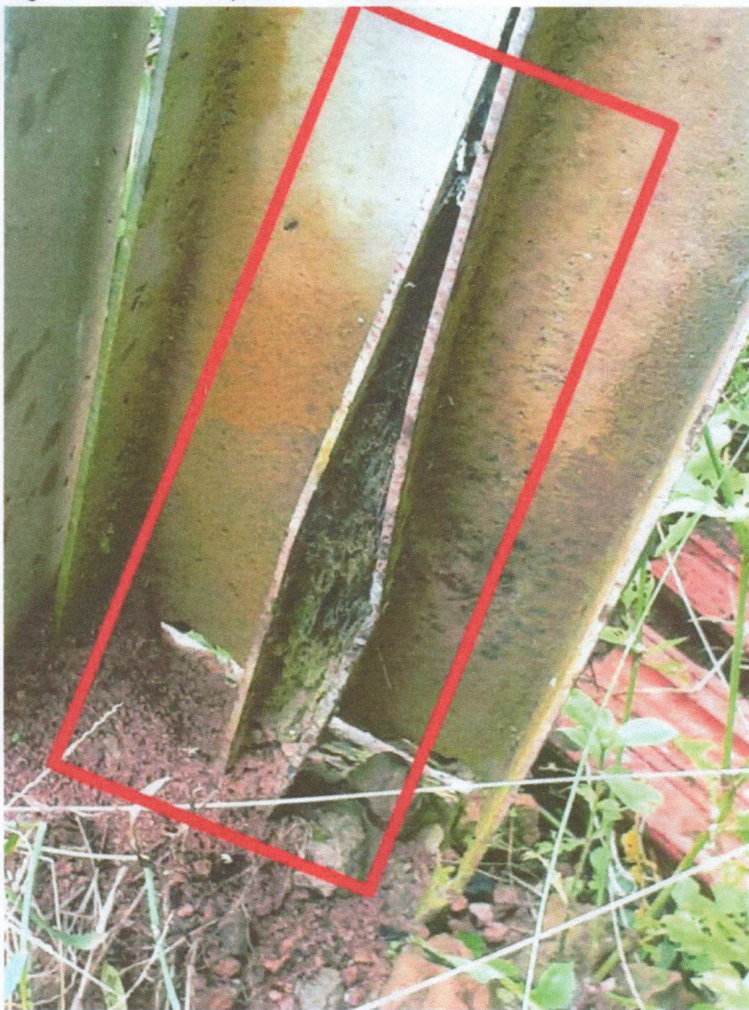
Figura 13. corrosão no pé direito da estrutura.
