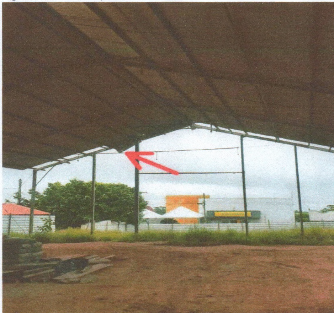
Figura 5: telhas se desprendendo da estrutura.
