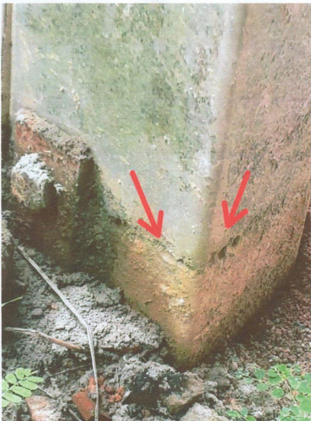
Figura 11. corrosão no pé direito da estrutura
