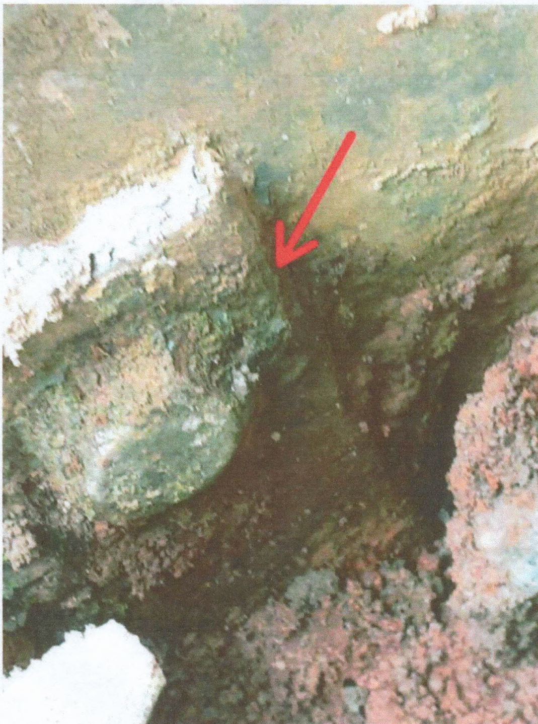
Figura 17. corrosão no pé direito da estrutura
